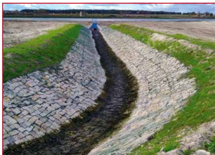
Fot. 7. Rów doprowadzający wodę do zbiornika umocniony materacami gabionowymi gr. 23 cm
