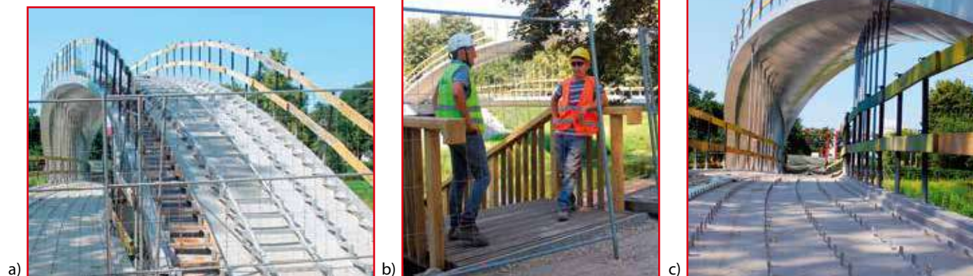
Rys. 12. Sierpień 2020 r.: a) kładka zabezpieczona srebrną powłoką ochronną; b) omówienie zadań na budowie; c) widok na górny pomost
