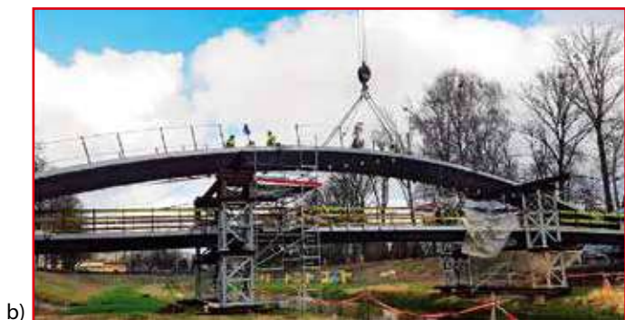
Rys. 8. Montaż i scalenie kładki na przyczółkach: a) zmontowany pomost dolny; b) podpory tymczasowe do pomostu górnego
