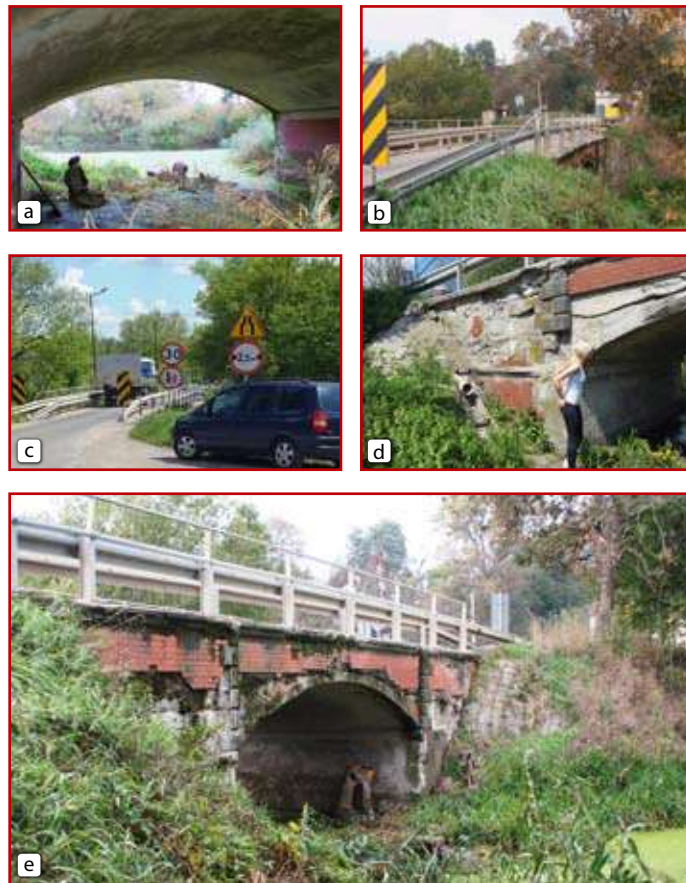
Rys. 4. Most w ciągu ul. Pliszczyńskiej: a) widok w dół cieku, b-c) ograniczenia prędkości i skrajni na moście, d-e) pozostałości ceglonej elewacji, odpowiednio od napływu i odpływu
