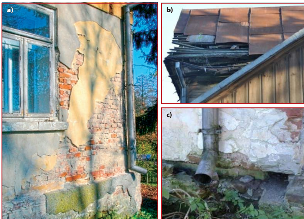
Rys. 6. Zniszczenia elewacji: a) uszkodzenia tynku elewacji południowej; b) ubytek pokrycia dachowego elewacji zachodniej; c) ubytki cegieł odsłaniające kanał wentylacyjny podłogi – elewacja północna
