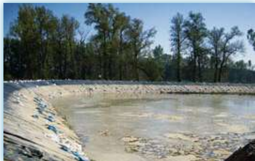
Wyrwa w wale w m. Popów
