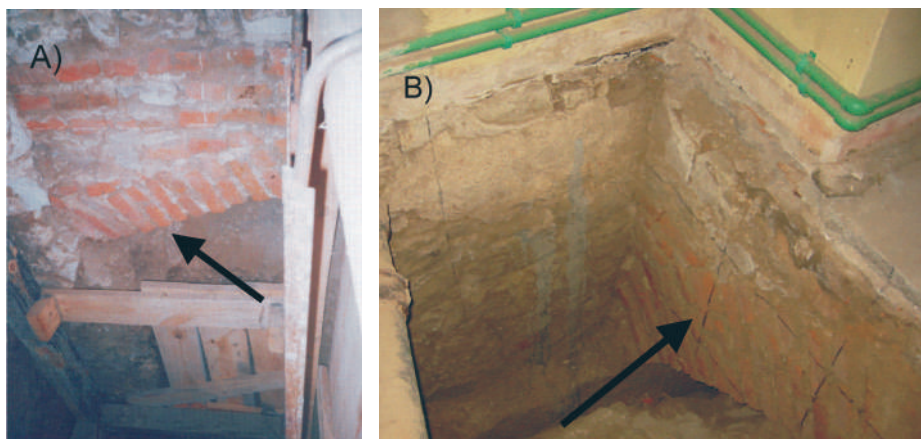
Fot. 1 Średniowieczne mury z kamienia wapiennego odkryte podczas prac związanych ze wzmocnieniem fundamentów skrzydła wschodniego: A) mur wewnątrz budynku, B) mur pod ceglany płaszczem ściany zewnętrznej
