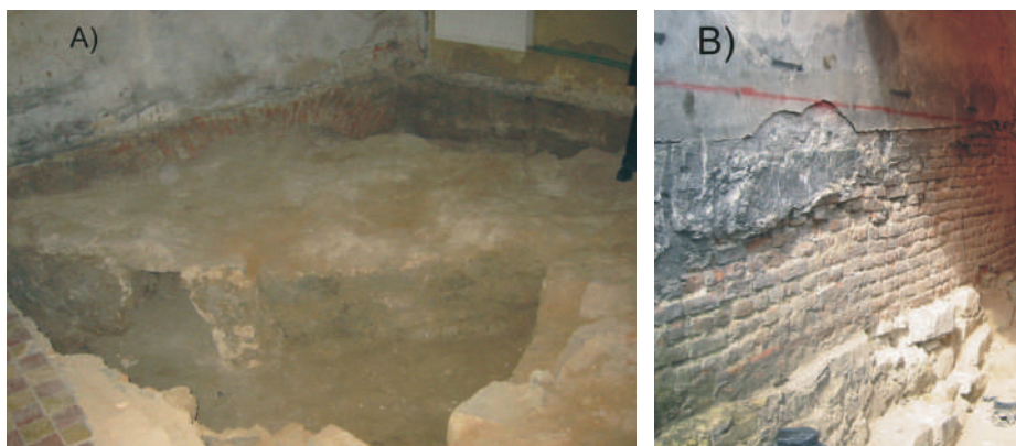
Fot. 1 Średniowieczne mury z kamienia wapiennego odkryte podczas prac związanych ze wzmocnieniem fundamentów skrzydła wschodniego: A) mur wewnątrz budynku, B) mur pod ceglany płaszczem ściany zewnętrznej
