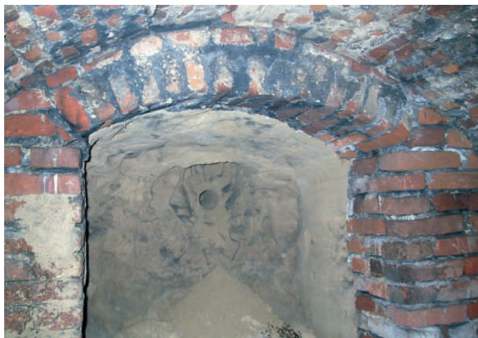
Fot. 4 Otwór w ścianie szczytowej piwnicy drugiego poziomu skrzydła wschodniego, znajdującej się pod ścianą zewnętrzną budynku
