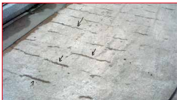
Rys. 1. Zarysowanie dźwigarów i płyty pomostu zarysowanie dźwigara, zarysowania płyty pomostu (stan w dwa dni po zabetonowaniu płyty pomostu, betonowanie przy temperaturze + 30 stopni).
