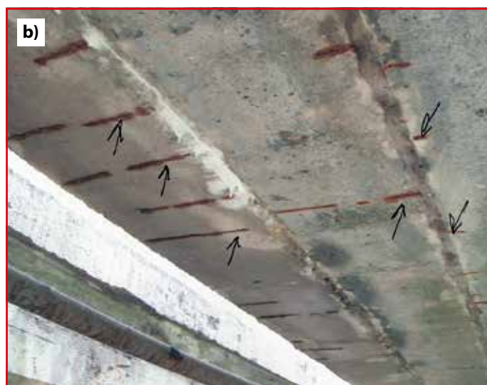
Rys. 10. Uszkodzenia słupa filara: a) brak otuliny betonowej, korozja zbrojenia w narożu; b) brak prawidłowej otuliny, ogniska korozji w belkach strunobetonowych sprężonych.
