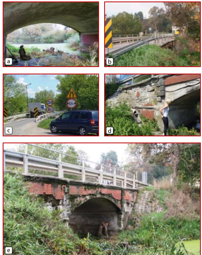
Rys. 4. Most w ciągu ul. Pliszczyńskiej: a) widok w dół ciek, b-c) ograniczenia prędkości i skrajni na moście, d-e) pozostałości klinkierowej elewacji, odpowiednio od napływu i odpływu
