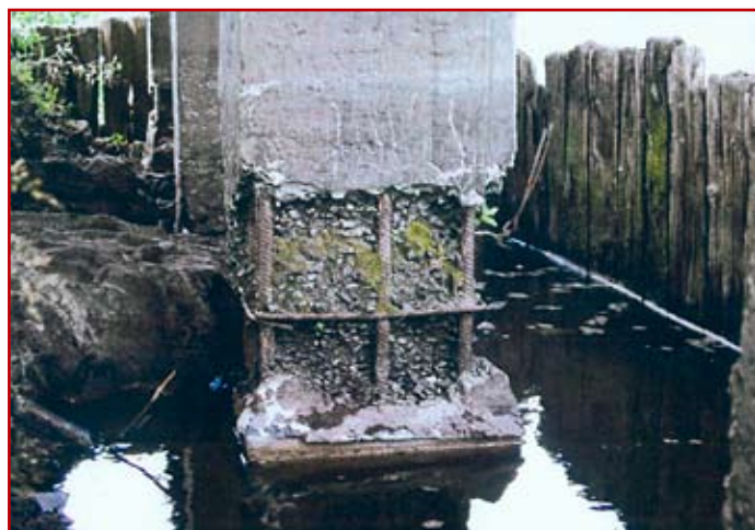
Fot. 5. Uszkodzenia korozyjne słupów filara – po wykonaniu odkrywki
