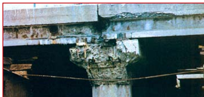
Fot. 2a. Uszkodzenie w strefie dylatacji przęseł
