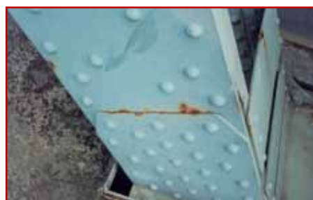
Rys. 4. Ogniska korozji w strefach węzłów kratownicy
