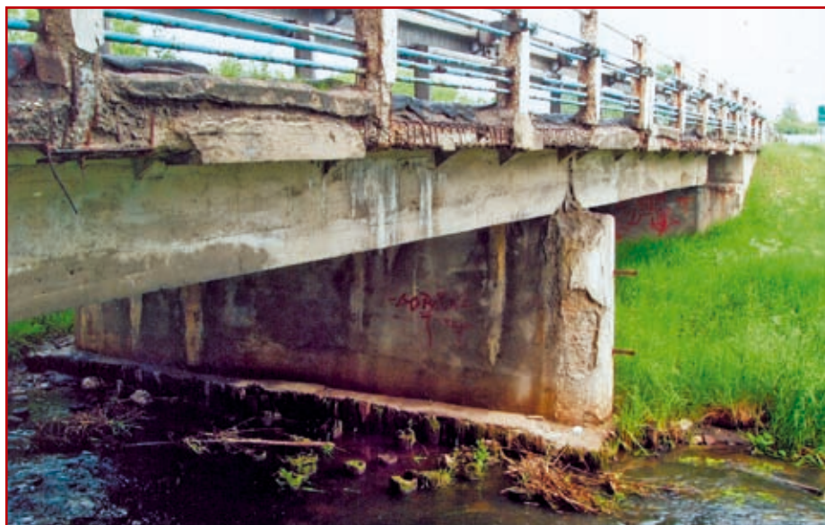
Zdj.1 Uszkodzenie dźwigarów głównych, belek gzymsowych, balustrady i podpór
