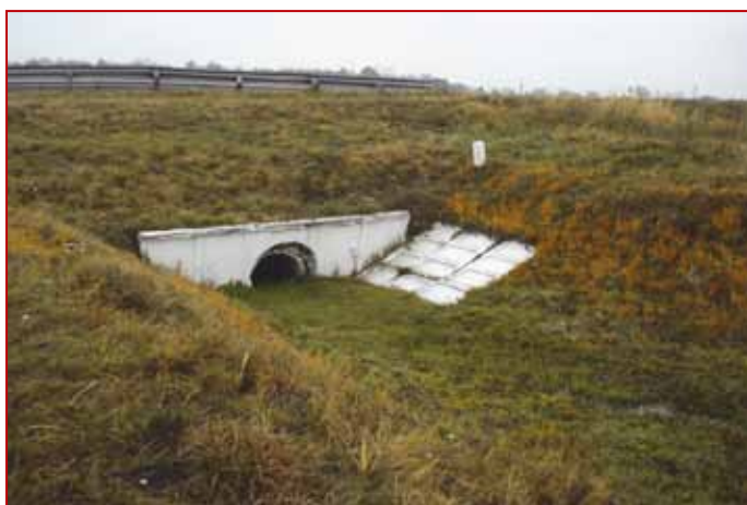
Budowla melioracyjna na obiekcie p.n.: Słotwyński
