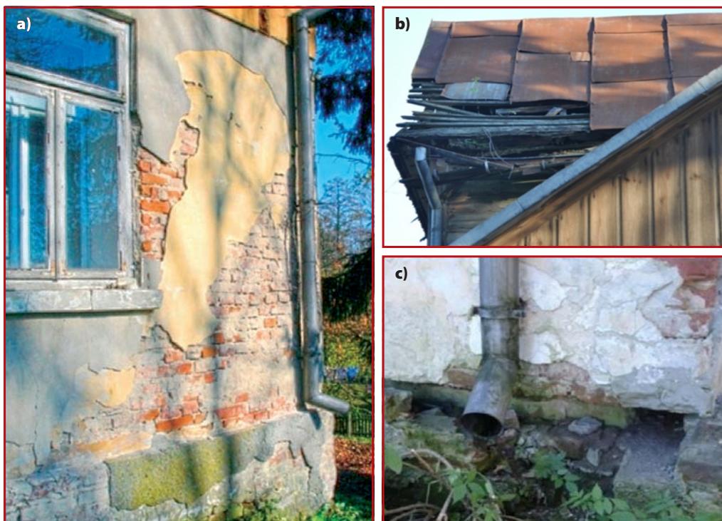
Rys. 6. Zniszczenia elewacji: a) uszkodzenia tynku elewacji południowej; b) ubytek pokrycia dachowego elewacji zachodniej; c) ubytki cegieł odsłaniające kanał wentylacyjny podłogi – elewacja północna
