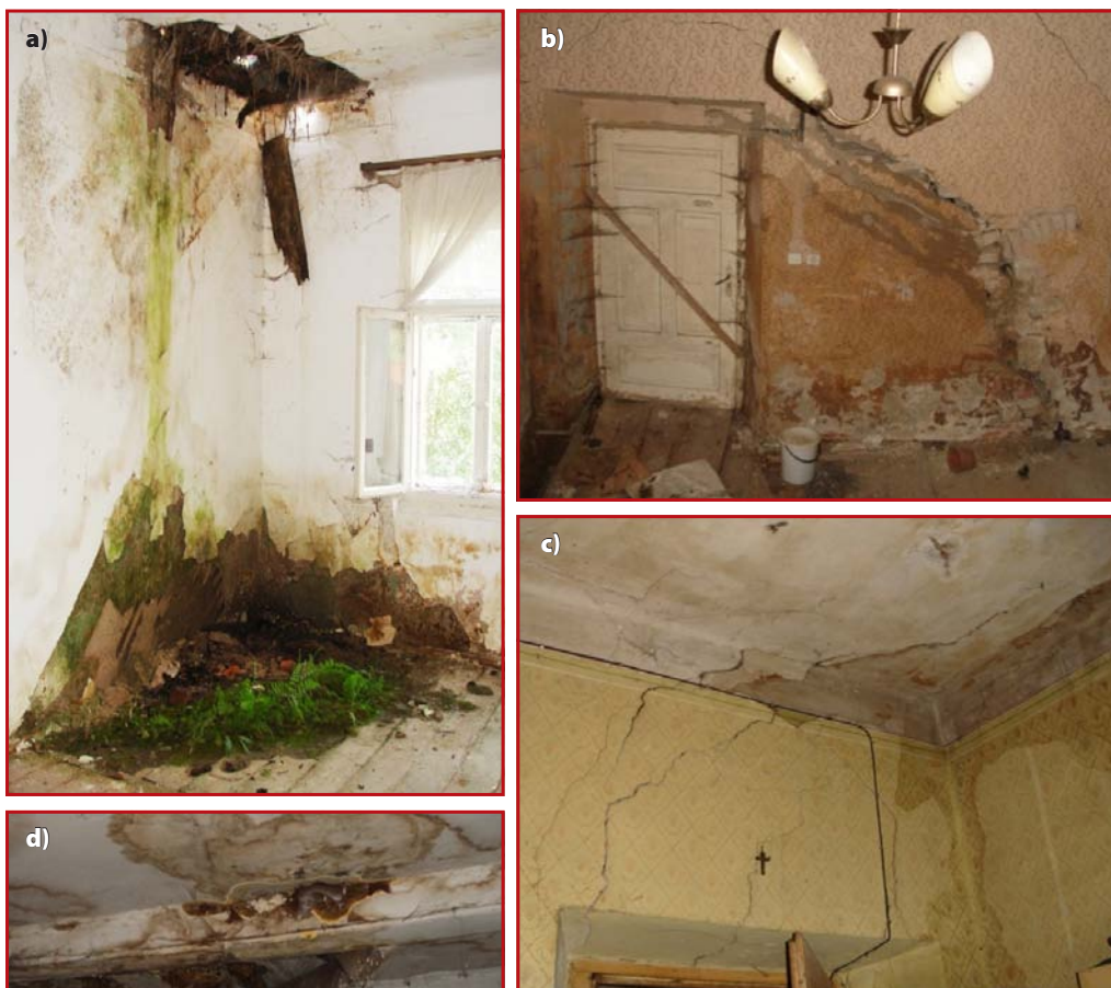
Rys. 7. Zniszczenia wewnątrz budynku: a) skutki ubytku pokrycia dachowego; b) zapadnięta ściana wewnętrzna budynku; c) zarysowania i zawilgocenia wewnętrznej ściany budynku; d) zawilgocone i zagrzybione belki stropowe
