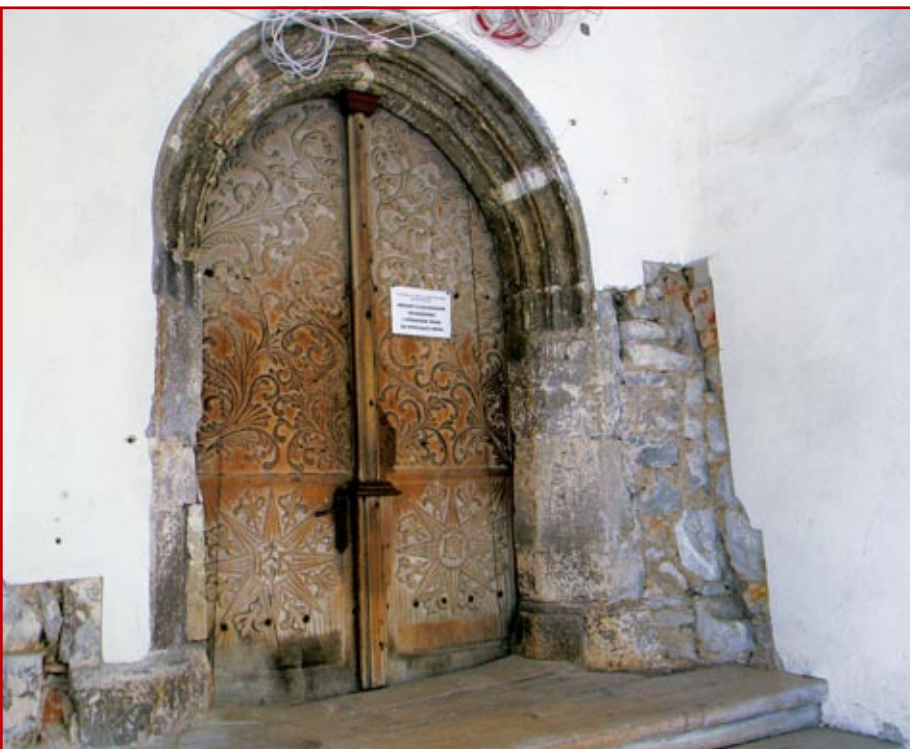
Zniszczone wejście główne
