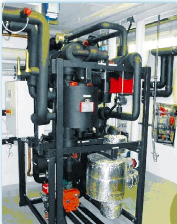
Rys. 2. Widok agregatu absorpcyjnego agregatu chłodniczego bez obudowy
