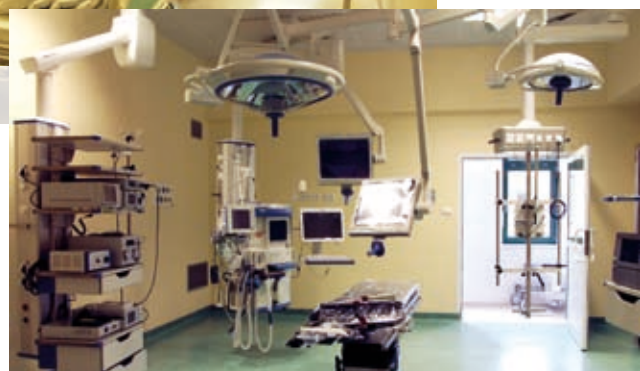
Pomieszczenie szpitalne z nowoczesnym wyposażeniem
