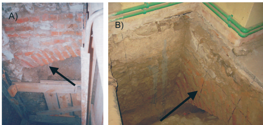
Fot. 1 Średniowieczne mury z kamienia wapiennego odkryte podczas prac związanych ze wzmocnieniem fundamentów skrzydła wschodniego: A) mur wewnątrz budynku, B) mur pod ceglany płaszczem ściany zewnętrznej
