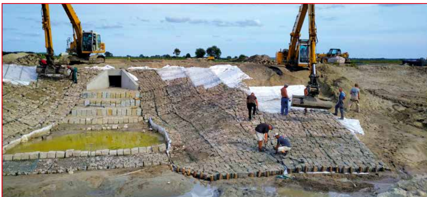
Fot. 5. Wylot rurociągu zastawki w grobli czołowej z kaskadą i niecką wypadową w trakcie robót
